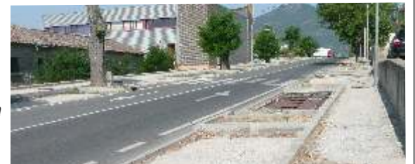
Carretera de Ávila, tras la paralización.
